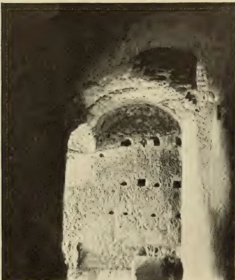
Abbildung 27. Blick in den oberen Lauf der Nordosttreppe, von oben her; das Loch im Gewölbe modern.
